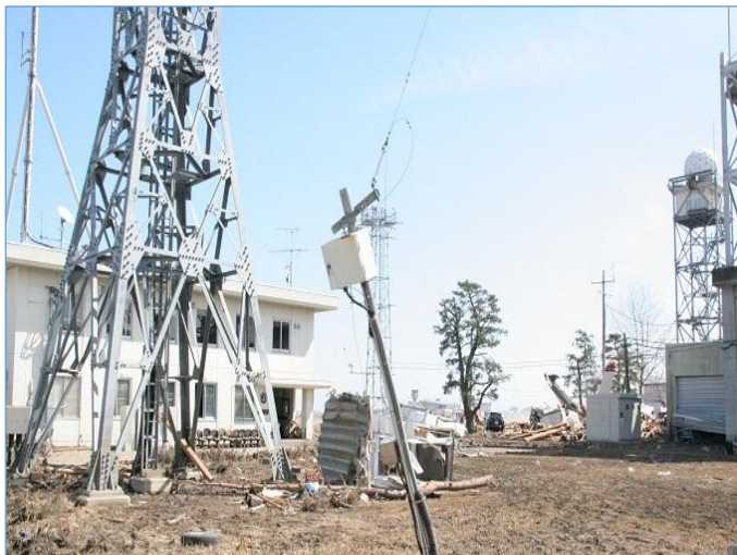
【津波により被害を受けた仙台航空基地の空中線設備】
