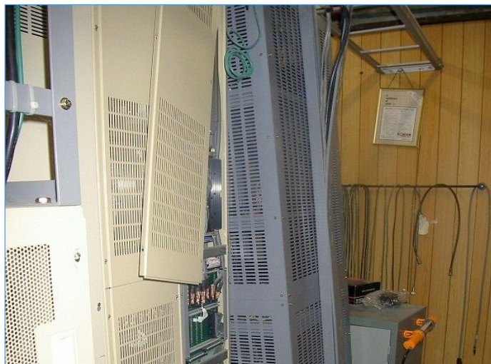
【地震により通信機器が傾斜した駒ヶ峰受信所の局舎】
