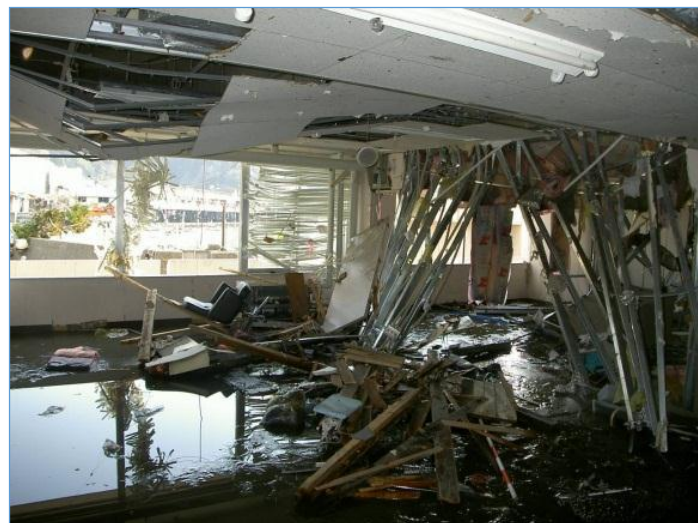
【津波で壊滅的ダメージを受けた庁舎：釜石】
