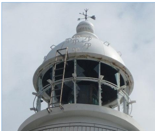
【灯台窓ガラスが破損した塩屋崎灯台：福島海上保安部】
