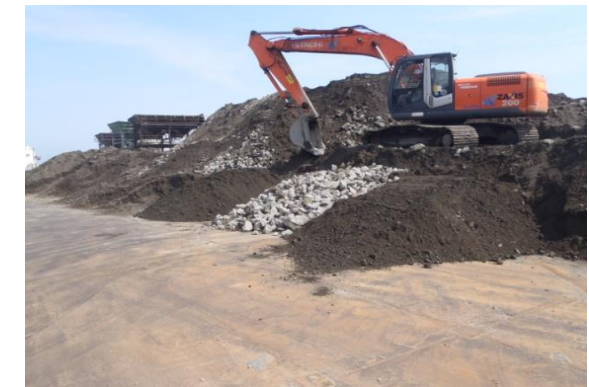
[撤去砂とコン殻運搬状況] コン殻 1 : 撤去砂 2 の配合割合はダンプ トラックで管理 (写真中央部の両側が撤去砂ダンプトラック 2 台分で中央部がコン殻でダンプトラック 1 台分)
