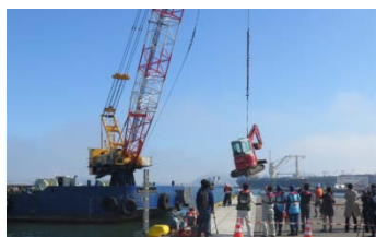
(一社)日本埋立浚渫協会東北支部による緊急資機材搬入訓練(バックホウ陸揚げ)
