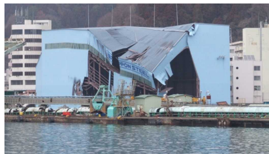
全天候型バースの被災状況(写真1)
