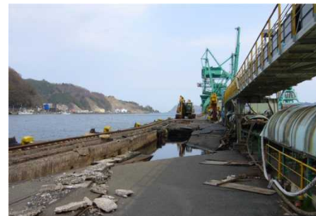
専用棧橋の被災状況(写真2)
