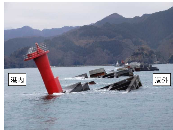
【写真】 北堤の倒壊状況
