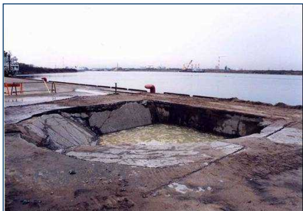
裏込め土の吸出しによる エプロンの陥没
