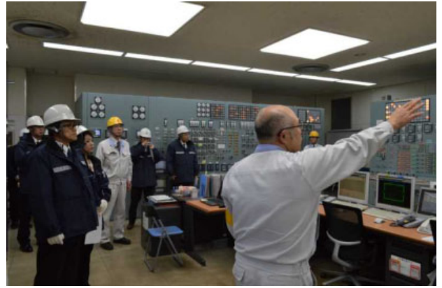
酒田共同火力発電所（制御室）
