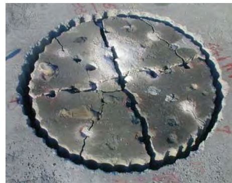
③静的破砕材によるひび割れ
