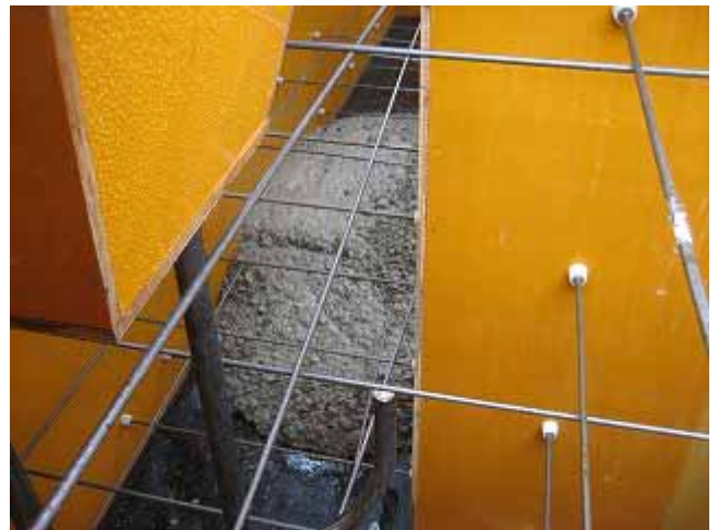
写真 4-4 シェルコンクリートの状況 (SS50%)
