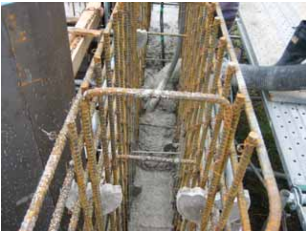
写真 4-13 シェルコンクリートの状況 (SS25%)
