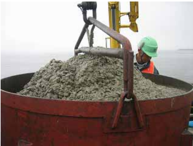
写真 4-3 シェルコンクリートの状況 (SS25%)
