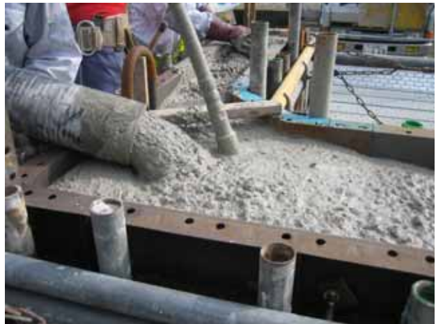
写真 4-14 シェルコンクリートの状況 (SS25%)
