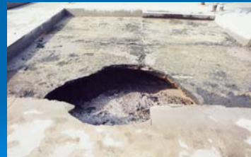
陥没の状況(志布志港)
