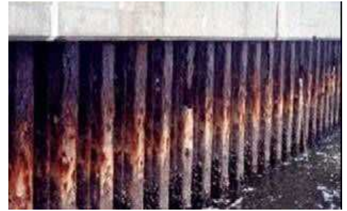
老朽化した直立鋼矢板護岸
