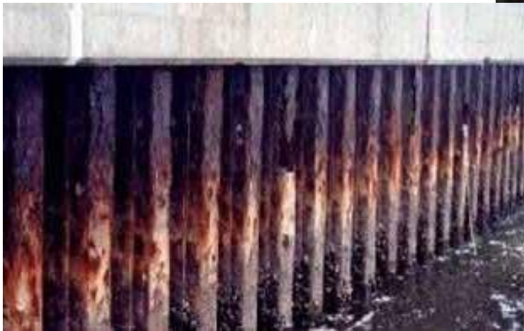
老朽化した鋼矢板の直立護岸
