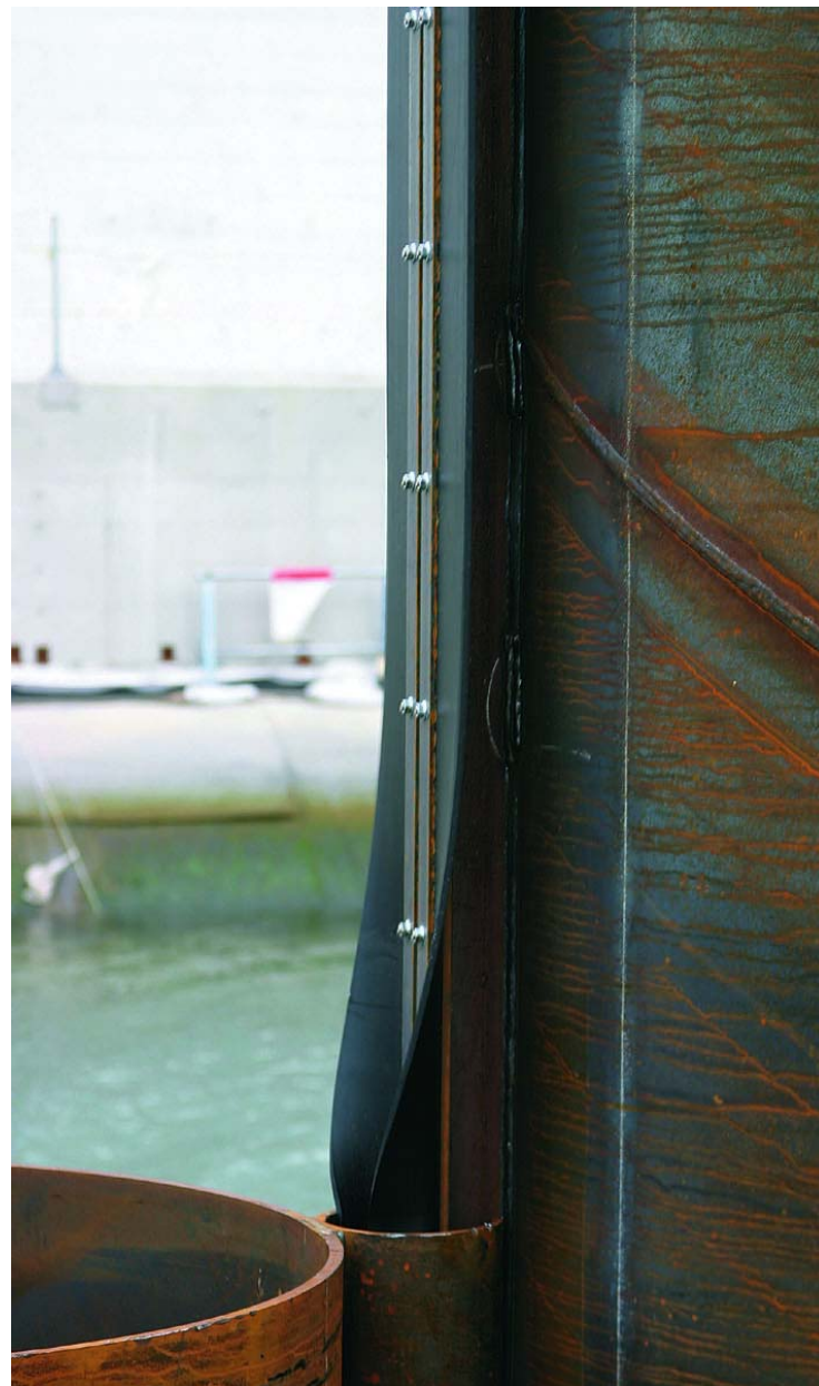
打設時の漏洩防止板ゴムの状況
