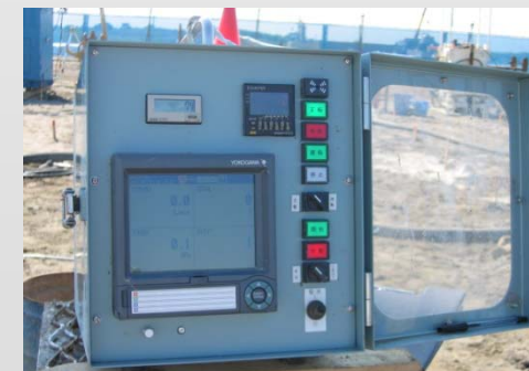
流量圧力監視装置
