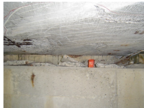
浮き、はくり、鉄筋の発錆
