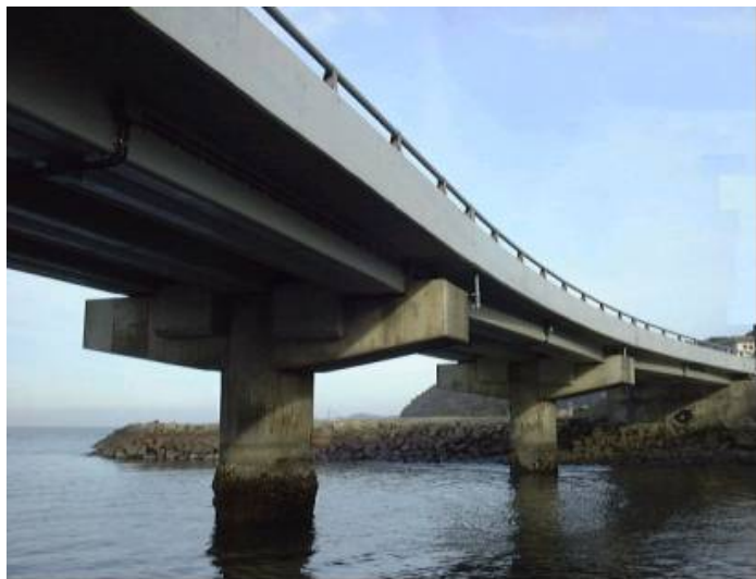
海浜地域でのT桁橋の劣化
