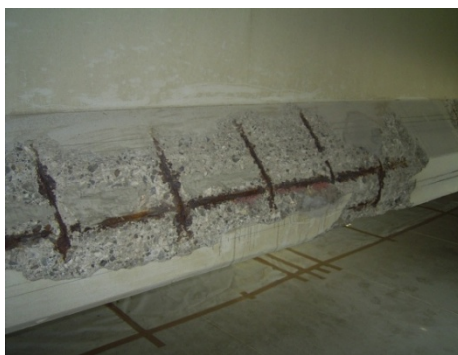
かぶりコンクリートの はくりと鉄筋の発錆
