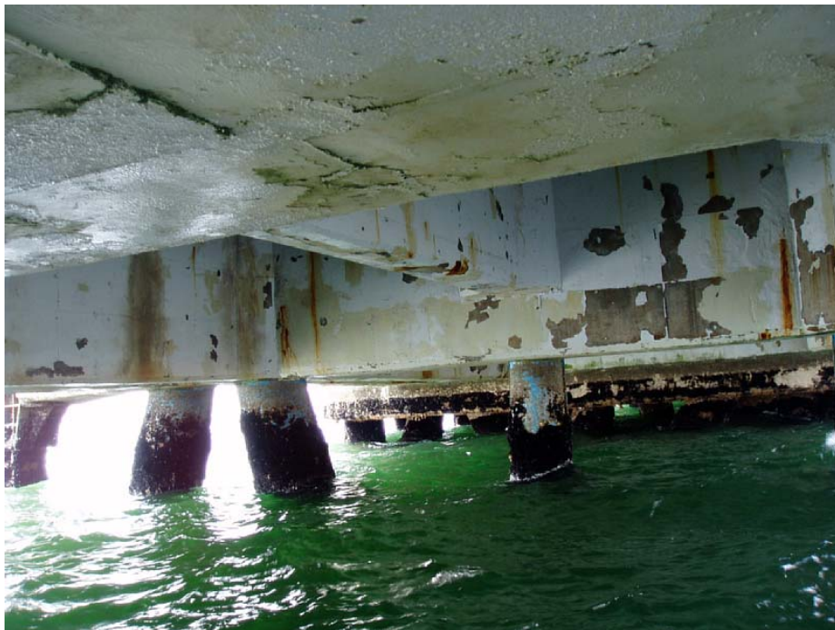
はり、スラブの塗膜の はがれと浮き
