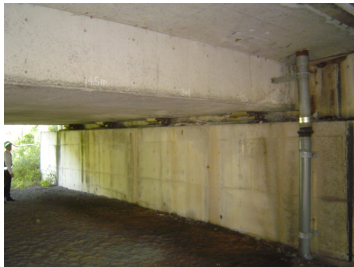
融雪剤による橋梁端部の劣化
