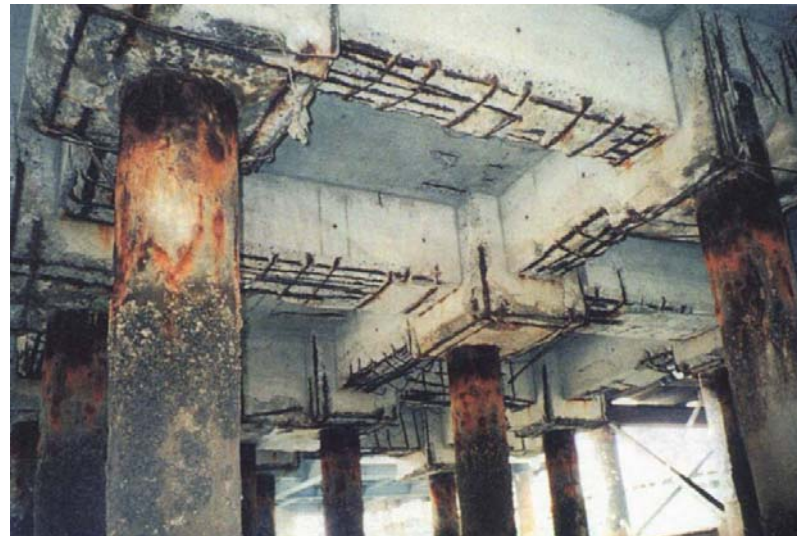
はつり後の発錆状況
