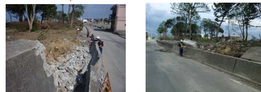
図-5 被災概要【駒ヶ嶺・今神地区護岸, 原釜護岸】
