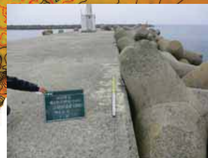
②テトラポットとの接触による上部工の破損
