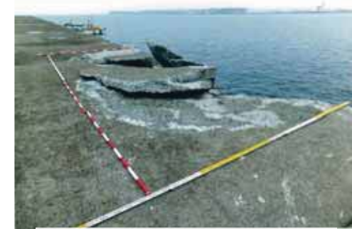
②船舶の衝突による上部工の損壊
