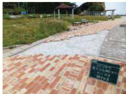
②インターロッキングの流亡
