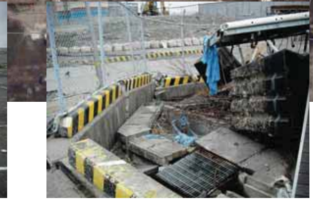
④トラフ部の沈下
