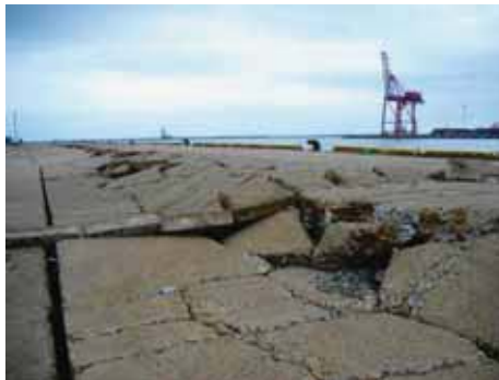
②地盤の隆起・沈下に伴う上部工の破損
