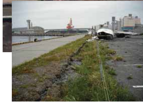
②岸壁土部の状況
