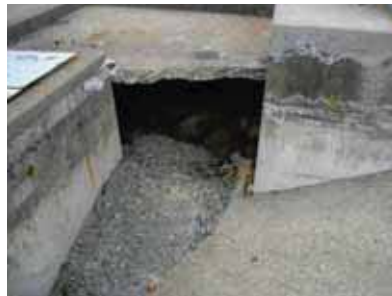
②地盤内部の空洞化と砂質土の流出
