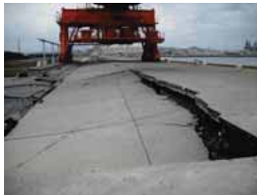
①地盤沈下により荷役機のレールが沈下
