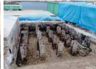
杭の腐食・変状調査
