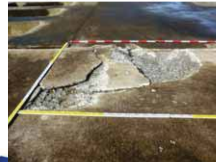
③ケーソン間の上部工表面の剥離
