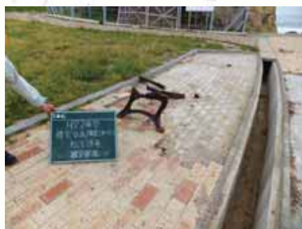
③ベンチの損壊
