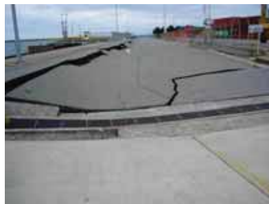
③大規模な地盤沈下
