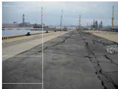
①岸壁陸側における地盤沈下
