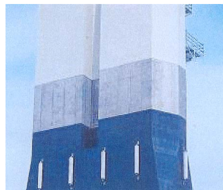
アクアライン橋脚の飛沫干満部 12
