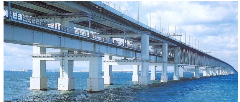
関西空港連絡橋飛沫干満部の防食
