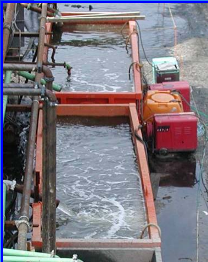
濾水槽(貯留槽)の事例
