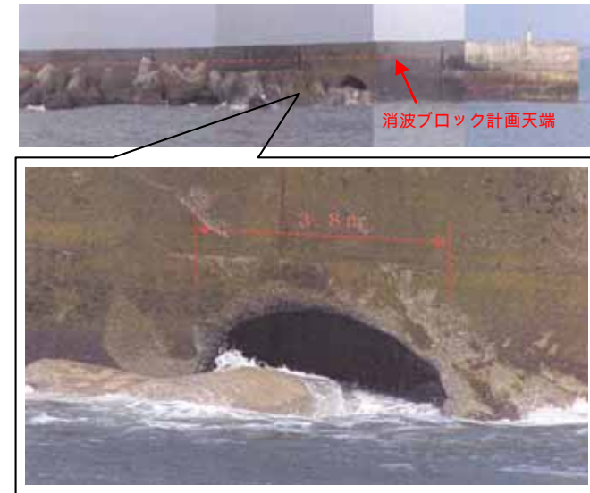
ケーソン壁穴あき被災事例
