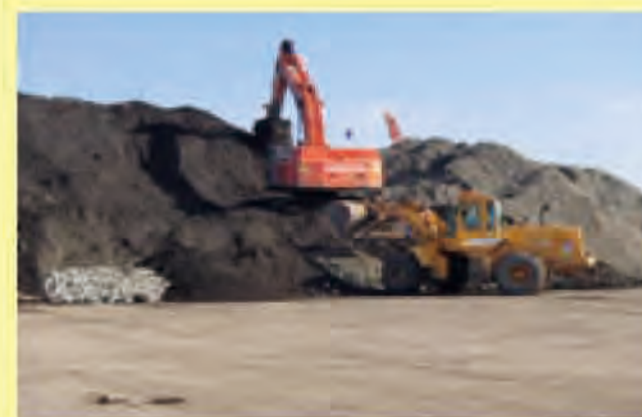
津波堆積土砂とコンクリート殻混合状況
