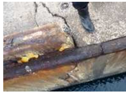
上部コンクリートのひび割れ
