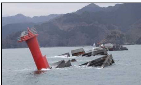
津波により破壊された湾口防波堤(釜石港)
