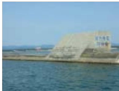
防波堤に設置された波力発電
