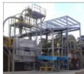
エタノール生成プラント
