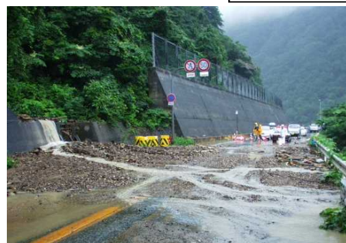
▲国道47号猪ノ鼻地区の被災状況
