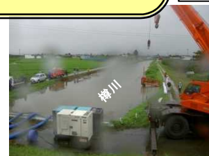
平成25年7月洪水時の状況
