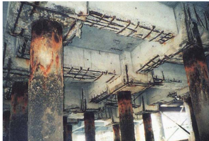
はつり後の発錆状況
