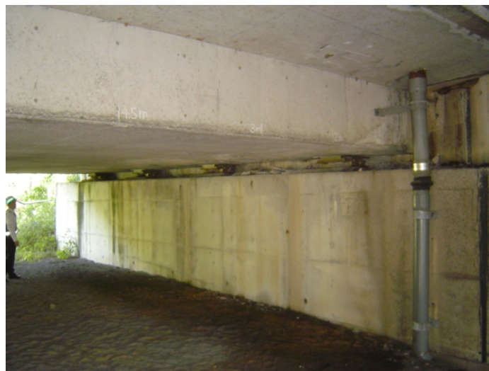
融雪剤による橋梁端部の劣化
