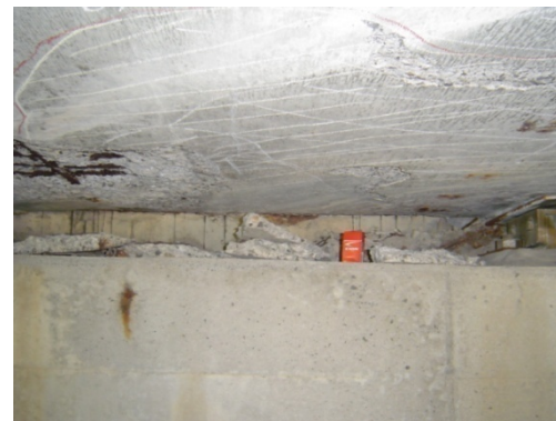
浮き、はくり、鉄筋の発錆
