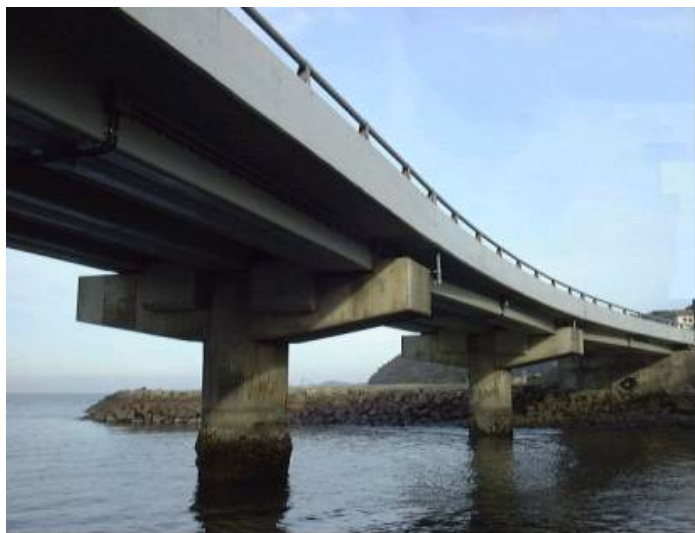
海浜地域でのT桁橋の劣化
