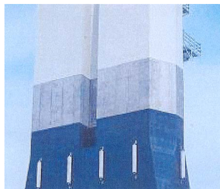
アクアライン橋脚の飛沫干満部
