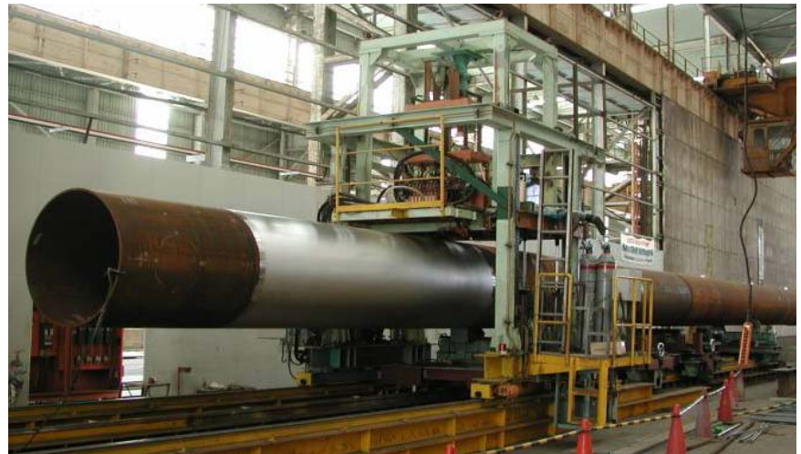
ステンレス被覆設備
