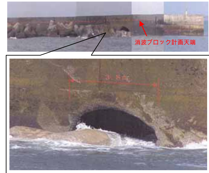
ケーソン壁穴あき被災事例
