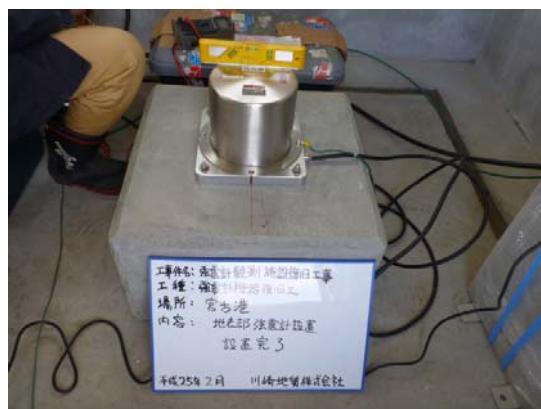
強震計観測機器（地上部）
