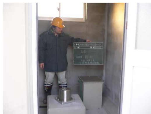
強震計機器（地上部）
