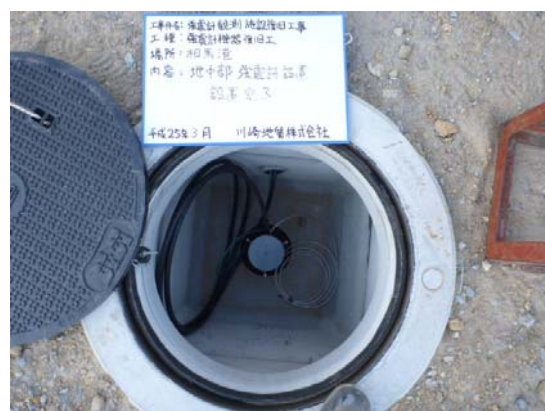
強震計（地中部）
