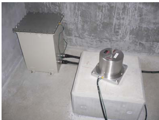
強震計機器（地上部）
