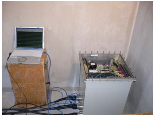
強震計機器（内部調整）
