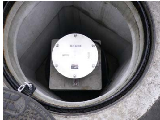
強震計機器（地上部ハンドホール内）
