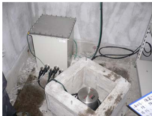
強震計、観測機器（地上部）
