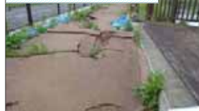
浅層混合処理工法の被災箇所
