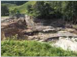
決壊した堤防(現地発生土にて築堤)
