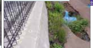
浅層混合処理工法の被災箇所
