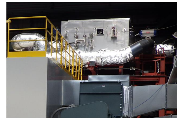
排ガス後処理装置
