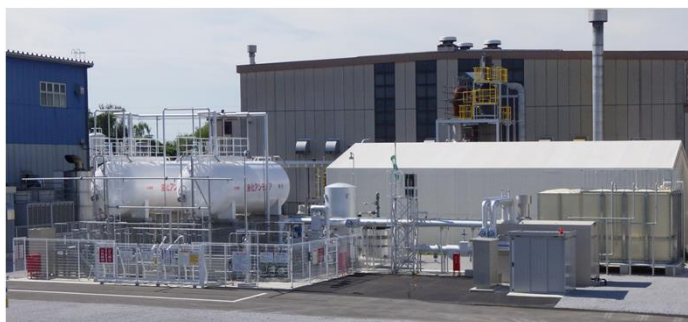
アンモニア燃料供給設備
