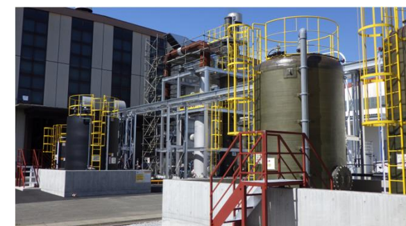
アンモニア除害設備
