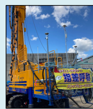
通信アンテナ
