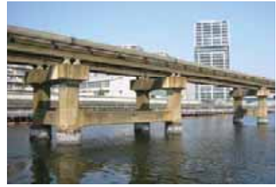
コンクリート支柱基礎杭耐震補強工事 東京モノレール(株):(H20.2~H21.7)
