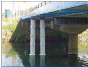
佐倉(耐震補強)通信設備総合工事 NTTインフラネット(株):(H21.11~H22.3)
