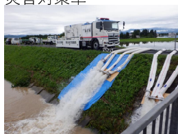
排水ポンプ車
